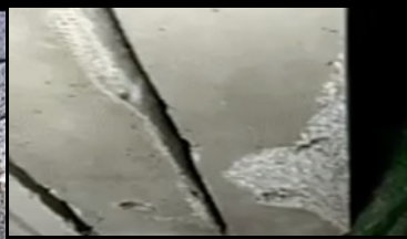
接缝开裂和剥落
